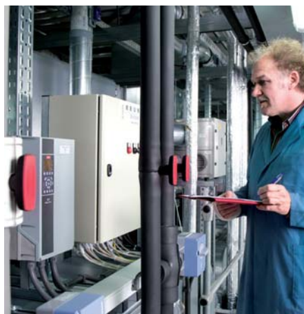
Ständige Überwachung der Lüftungstechnik
